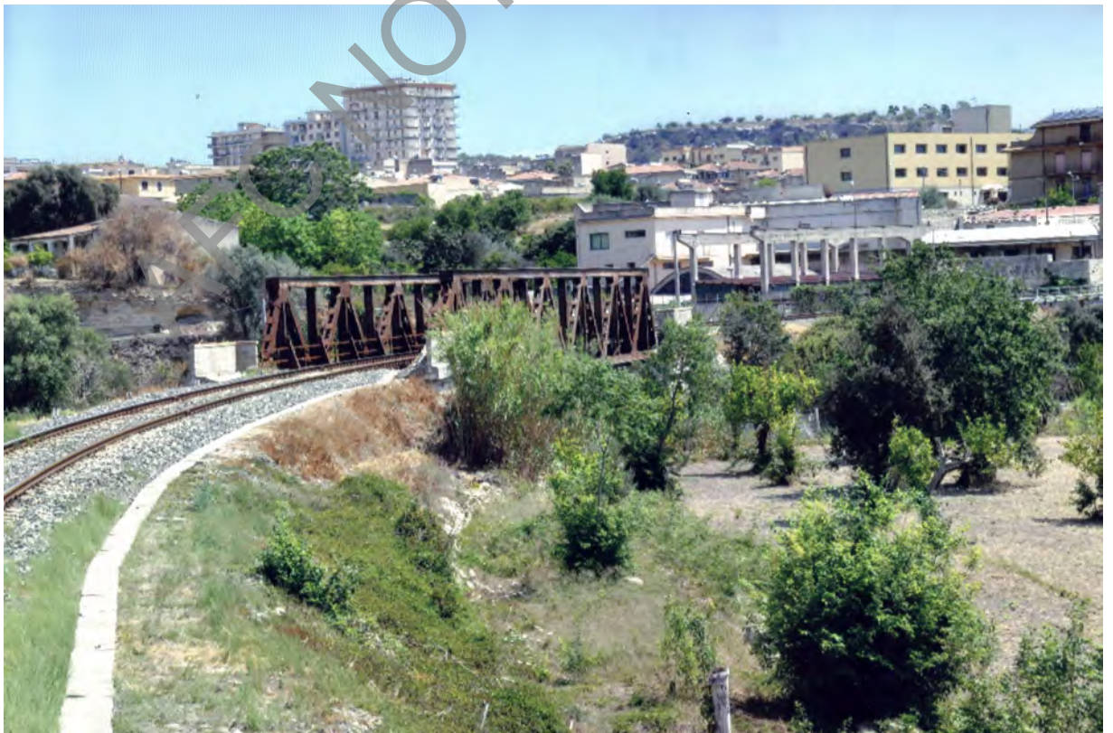
Ponte a capriata metallica "tipo Weber" a spalla alta sul fiume Asinara in uscita da Noto in curva con pendenza del 15‰
